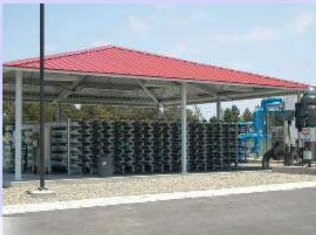
Isola di Capo Verde, Impianto acqua mare da 50 m 3 /h
