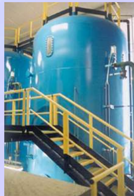
Publiacqua (FI) – Impianto di denitrificazione biologica Capacità 720 m 3 /h, in esercizio dal 2003
