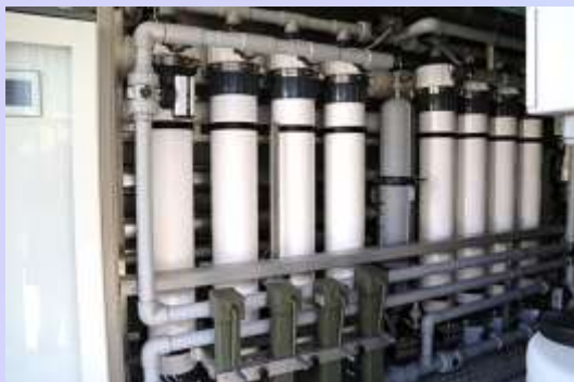
Ministero della Difesa Impianto in container da 70 m 3 /d
