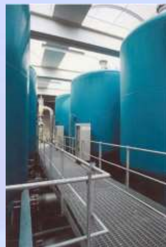
TEA Mantova, Impianto di Villanova Maiardina da 720 m 3 /h
